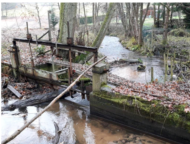
Barrage hydraulique sur la Moder, obstacle à la circulation de la faune et des sédiments © SDEA
