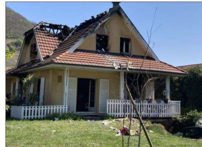
La maison a été fortement endommagée par les flammes.
